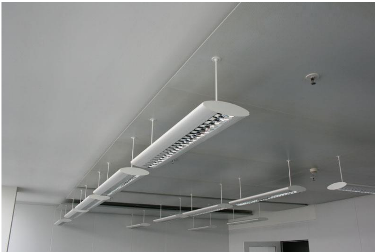
Готовый металлический кассетный потолок
